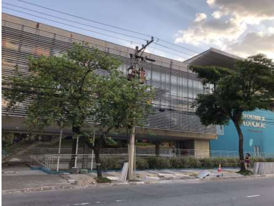
Figura 28 - Reforma da calçada em frente ao prédio da Secretaria de Educação de São Caetano do Sul
